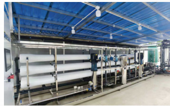
8万吨/年 含磷废水达标排放示范工程
