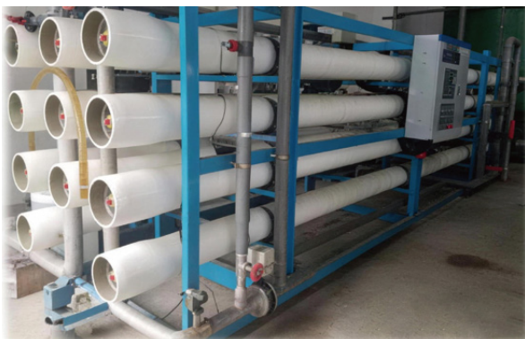
醋酸钠废水零排放示范装置
