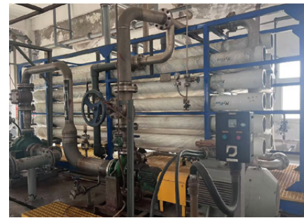
1000吨/天氯碱脱硝项目纳滤膜工段
