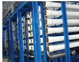
1万吨/日 王子造纸废水二期改造工程
