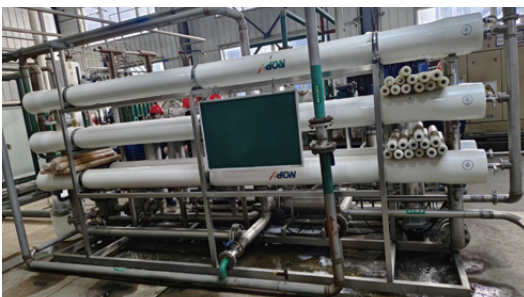
600吨/天赤霉素发酵液纳滤装置
