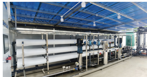
农药废水膜处理系统
