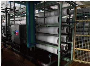
146万吨/年 煤制乙二醇废水资源化示范工程
