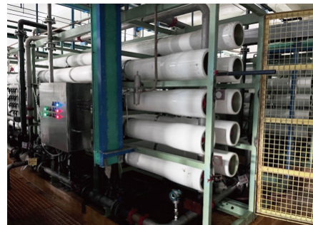
4000吨/天煤制乙二醇废水资源化项目 纳滤膜工段
