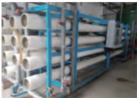
醋酸钠废水零排放示范装置
