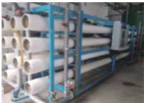
醋酸钠废水零排放示范装置
