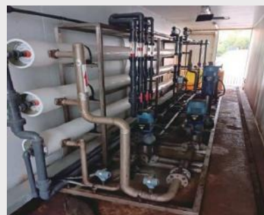
垃圾渗滤液处理项目
